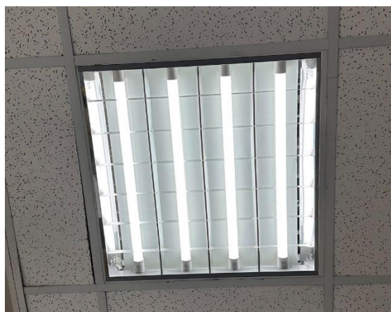
辦公室與教室電燈接汰換成高效率節能燈管
